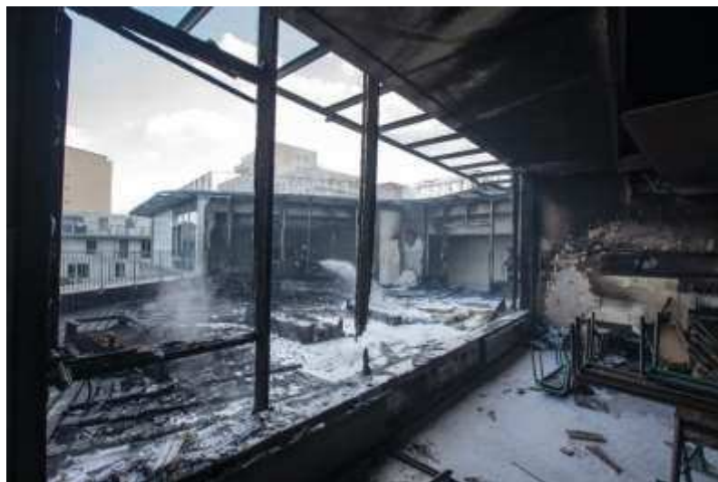
Photo n°1 (@BSPP) : Feux sur un toit-terrasse, avec propagation aux locaux adjacents
